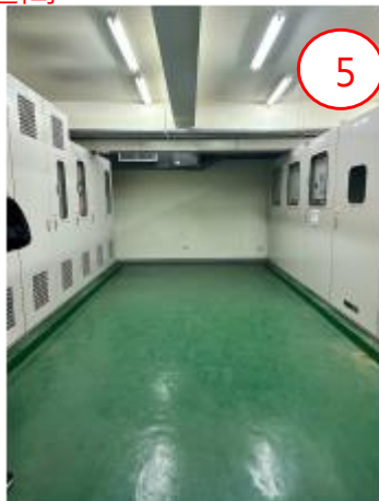
線槽由汽車格方向往前延伸至行政大樓機電房
